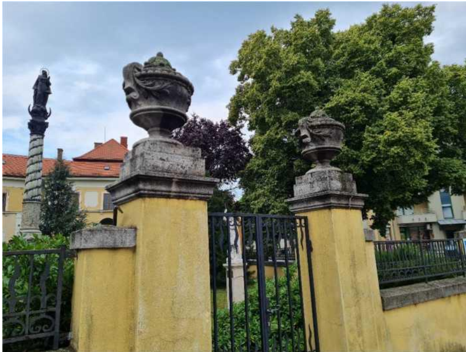
A kerítés északnyugati szakasza az erősen koromszennyezett műkővázákkal, fedkövekkel
