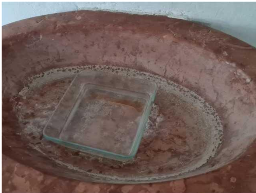
Vízkölerakódás a jobb oldali szenteltvíztartó belső karéjában
