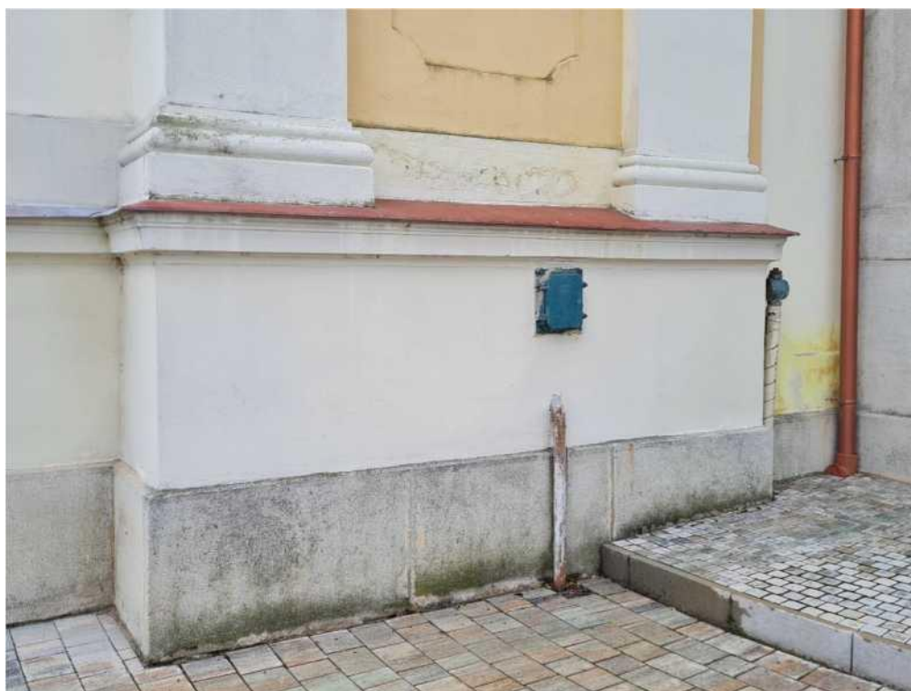
A lábázat talajhoz közel eső szakaszán a biológiai károsítók megléte koncentráltabb - feljebb - a pilaszter talpakon - feltáskásodott festékrétegek láthatók
